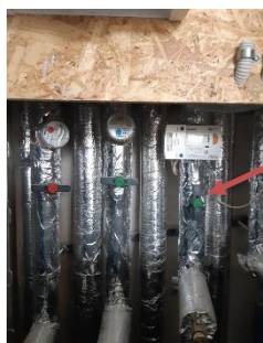
Måler og lukning for vand og Fjernvarmvarme. Venstre lejlighed
